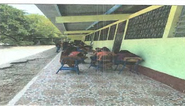
Foto 4: Patio en mal estado
