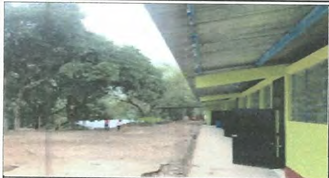
Foto 1: patio sin losa y sin techado
