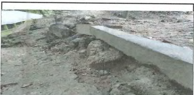
Foto 3: Parte del patio Mal estado
