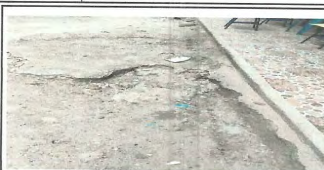
Foto 2: patio en mal estado
